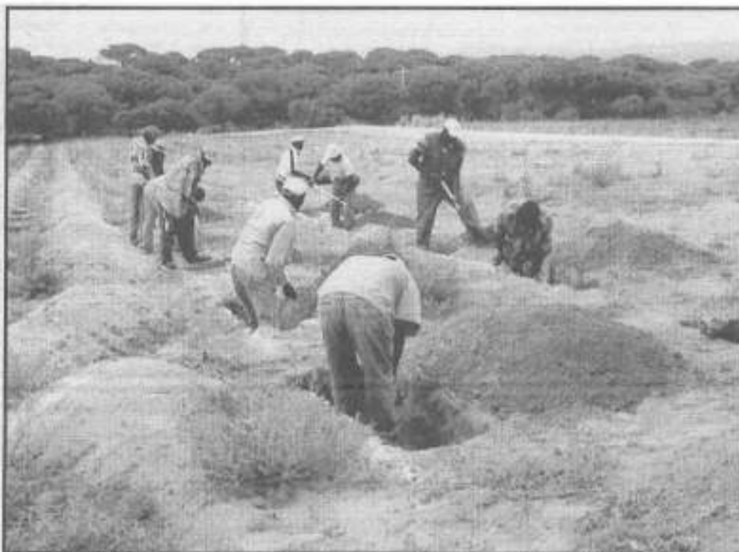
Un grupo de inmigrantes cava las fosas para la obra, en una foto cedida por la Fundación Montanmedio.
